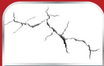
ผนังร้าว CRACKED WALL
